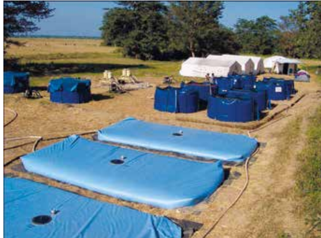
TRINKWASSERAUFBEREITUNGSANLAGE in Afrika.
